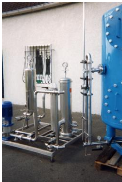
TRAITEMENT EAU CHARBON UV GUADELOUPE
