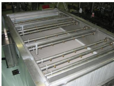
Tuyauteries aux rampes gicleurs démontables pour l'inspection.
