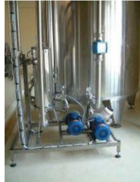
REALISATION D'UN PROCESS TRAITEMENT D'EAU REMINERALISATION
